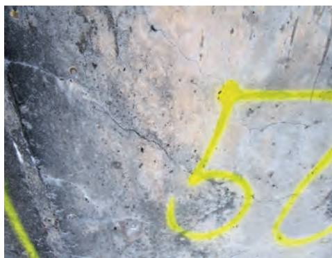
Beim Strahlen wurde erkannt, dass in den Betonflächen massive AKR-Schadstellen vorhanden sind.
