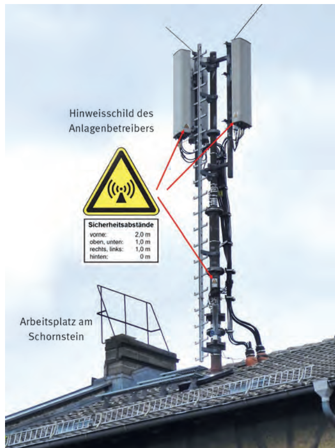
Funkantenne auf dem Dach neben dem Schornstein
